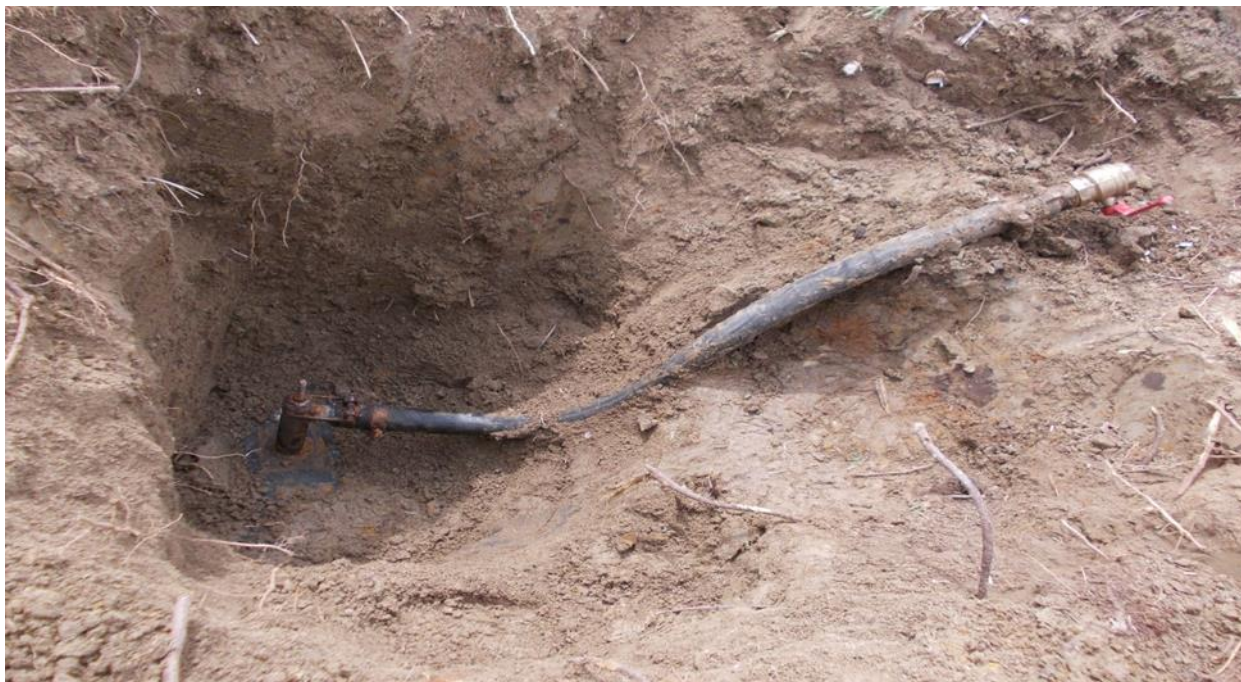
Рисунок 2 – Криминальная врезка в магистральный нефтетрубопровод
