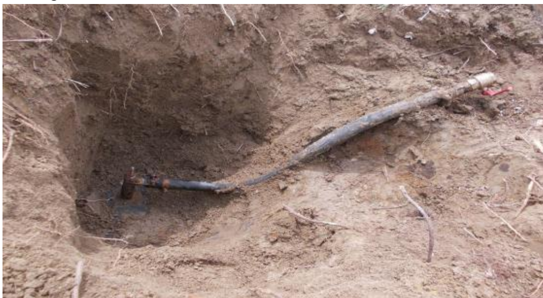
Рисунок 6 – Криминальная врезка в магистральный нефтетрубопровод
