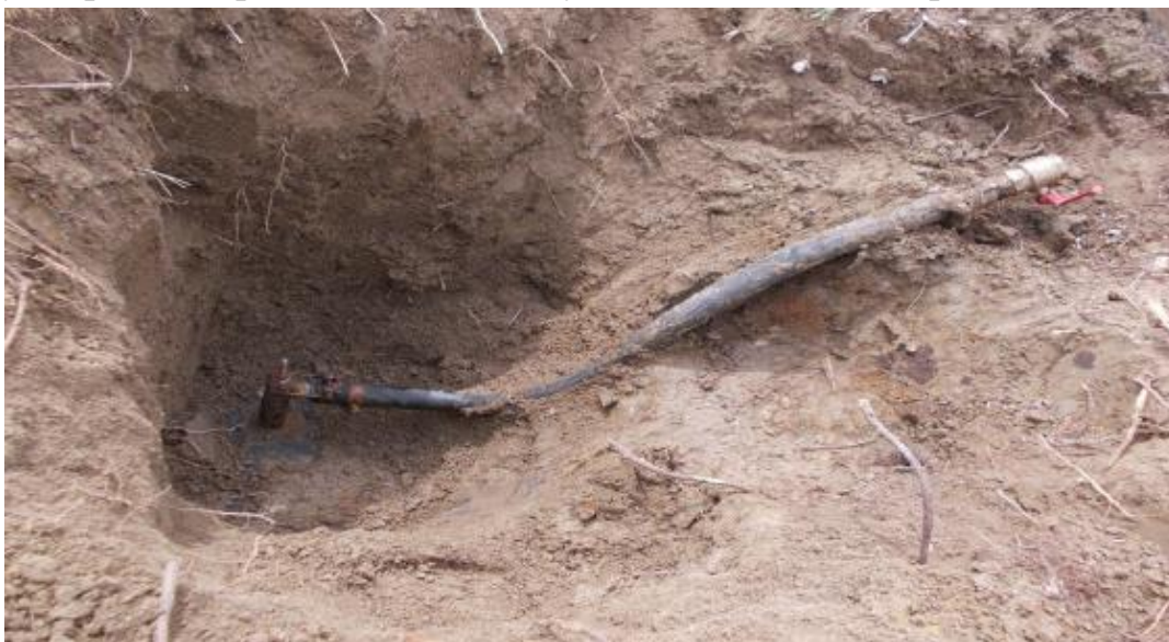
Рисунок 6 – Криминальная врезка в магистральный нефтетрубопровод
